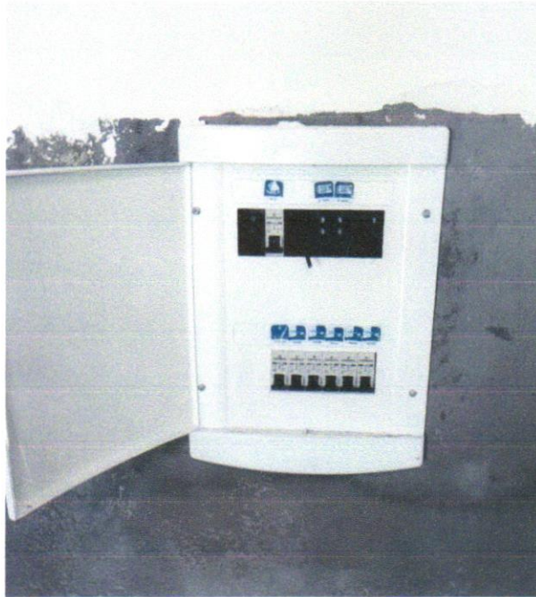
Foto 07– DISJUNTOR MONOPOLAR TIPO DIM, CORRENTE NOMINAL DE 10A , 16A E 40A – FORNECIMENTO E INSTALAÇÃO
