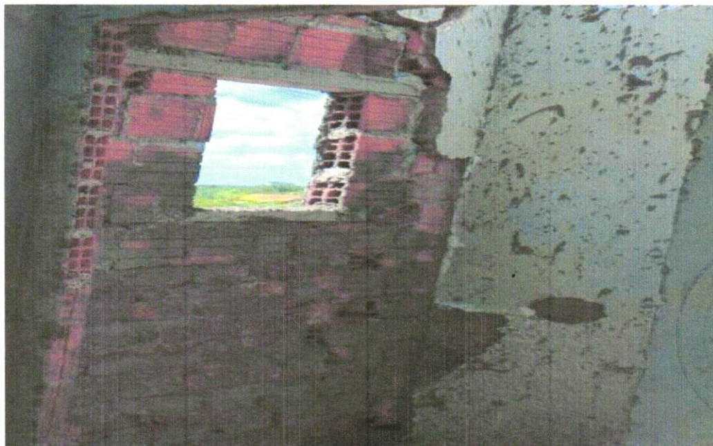
FOTO 10 - CHAPISCO APLICADO EM ALVENARIA (COM PRESENÇA DE VÃOS) E ESTRUTURAS DE CONCRETO DE FACHADA, COM EQUIPAMENTO DE PROJEÇÃO. ARGAMASSA TRAÇO 1:3 COM PREPARO EM BETONEIRA 400 L. AF_06/2014
